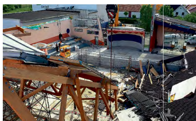
April bis Mai 2022: Die Beräumung der Einsturzstelle ist in vollem Gange: Wie beim Mikado werden unter hohen Sicherheitsauflagen alle Teile gesichtet und geborgen – alles in engem Kontakt zu Behörden und Prüfern. Fotos (3): SWS
