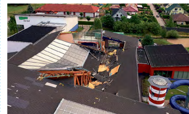
Juli 2021: Erste Luftaufnahmen zeigen das Ausmaß der Zerstörung. Das Dach des Sportbades war am Nachmittag des 11. Juli 2021 mit einem Krachen eingestürzt. Verletzt wurde zum Glück niemand. Wegen Sanierungsarbeiten war das AquariUM zu diesem Zeitpunkt geschlossen.
